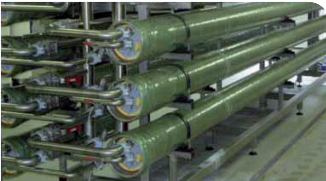
Abb. 4: Membrananlage im Wasserwerk Aistaig
